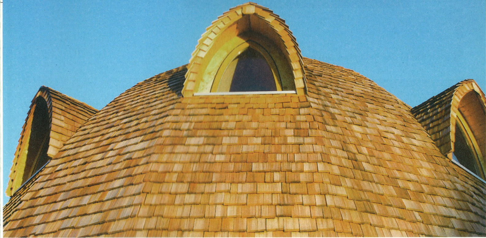
Neben den drei Dachgauben erfolgt die Belichtung des Meditationsraumes über die Dachöffnung und zwei Nebeneingänge
